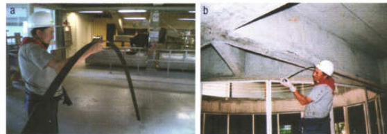
Foto 9. (a) Platina de carbono Sika CarboDur S512 . (b) Instalación de la platina de carbono en la parte inferior de una viga.
